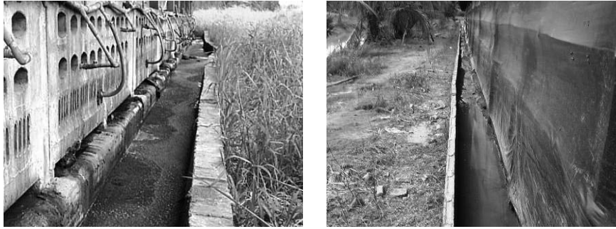
รูปที่ 6.4-7 ลักษณะรางระบายที่มีของเสียตกค้างและรางระบายน้ำที่ไม่มีของเสียตกค้าง
